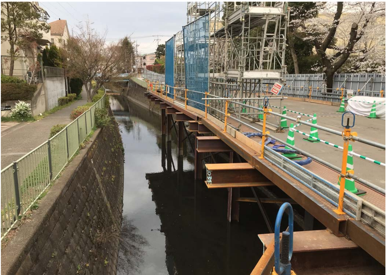
栈橋構台より永福橋側：護岸撤去・栈橋設置工 34m設置
