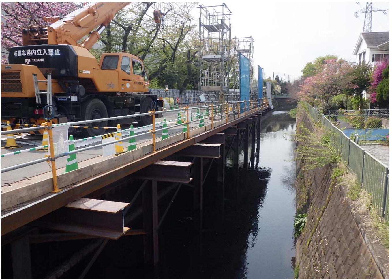
栈橋構台よりかな橋側：護岸撤去・栈橋設置工 46m設置
