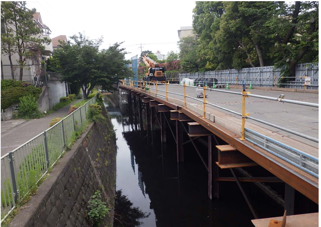
栈橋構台より永福橋側：栈橋設置工・護岸撤去工 52m完了
