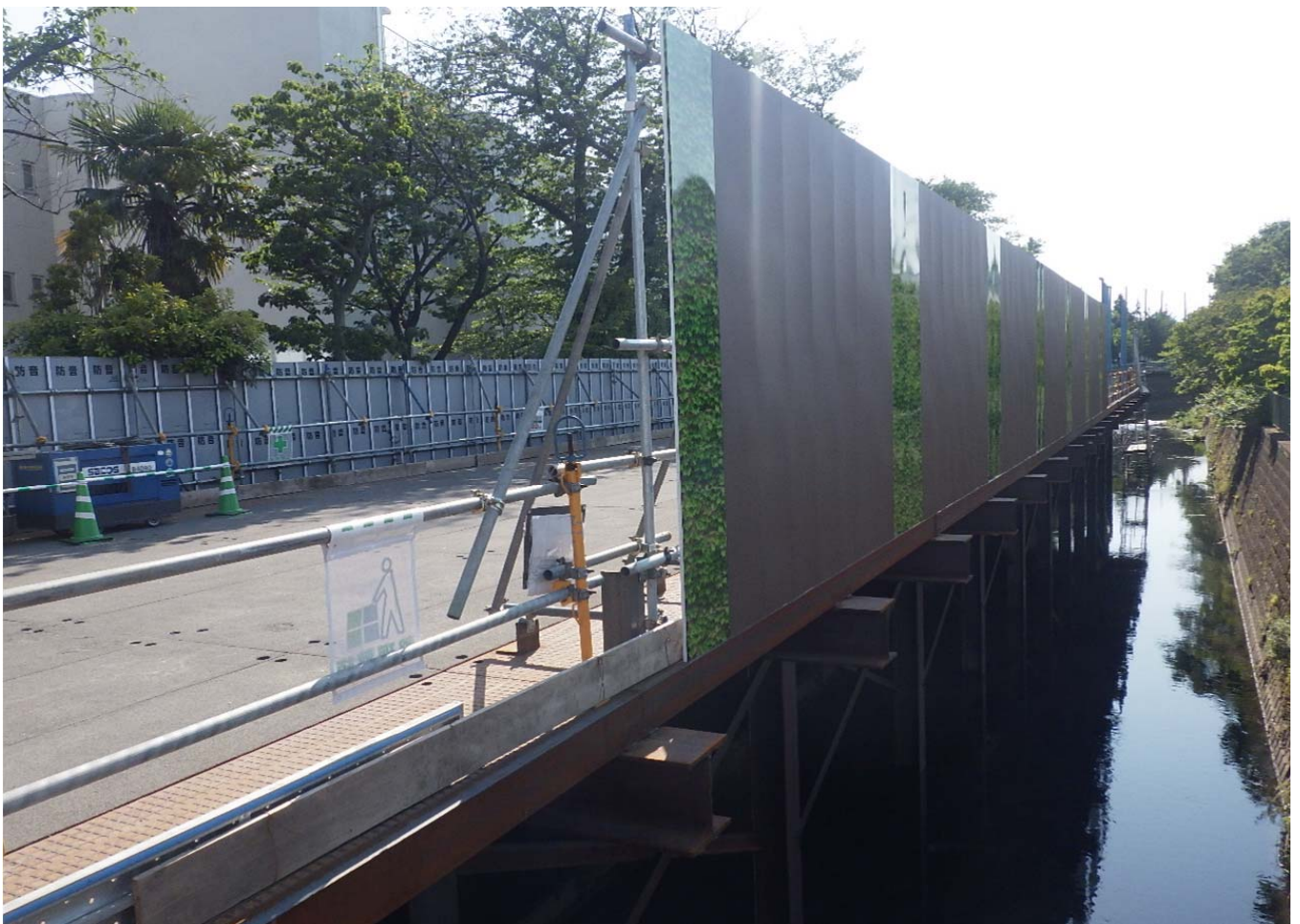
栈橋構台よりかな橋側：栈橋設置・護岸撤去工 6.5 m設置
